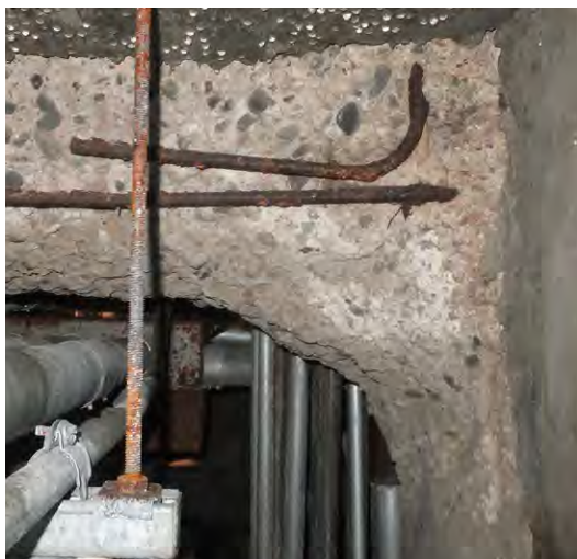
写真5 共同溝内部に残る古いコンクリート
