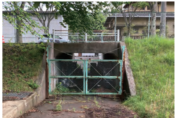
図20 都市計画道路で分断されたキャンパス南北を繋ぐアンダーパス（2024年6月筆者撮影）
