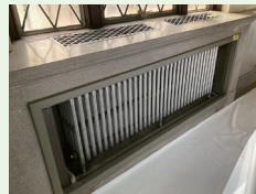
fig.1: 講堂の窓台に組み込まれていたラジエータ
